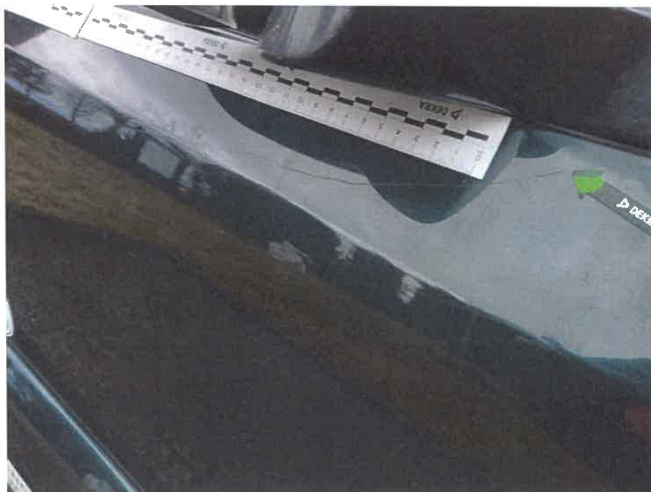
Fot. 38. Drzwi P P - zarysowanie 1
