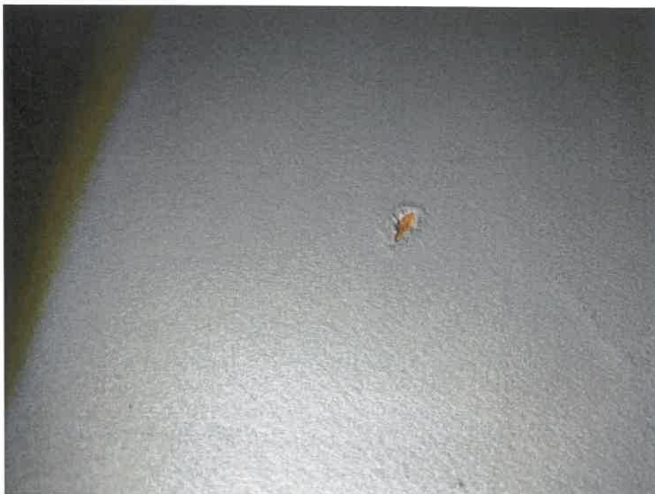
Fot. 65. Podsufitka standard. - pęknięcie 1
